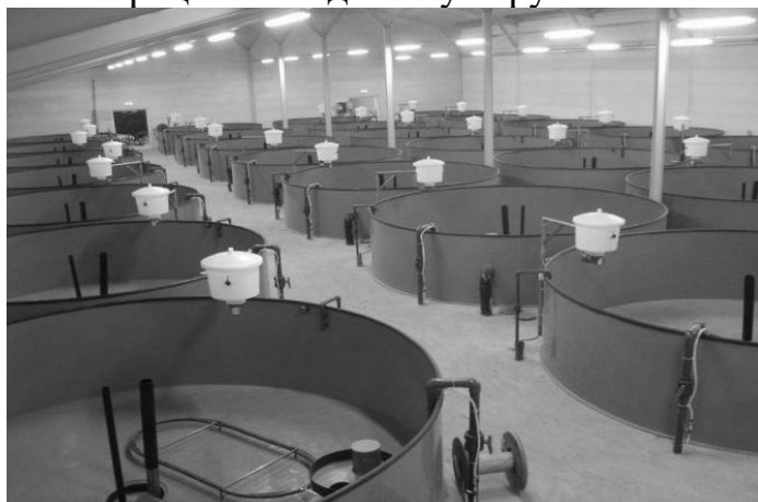
Рис. 15.13. Автогодівниці, змонтовані над басейнами
