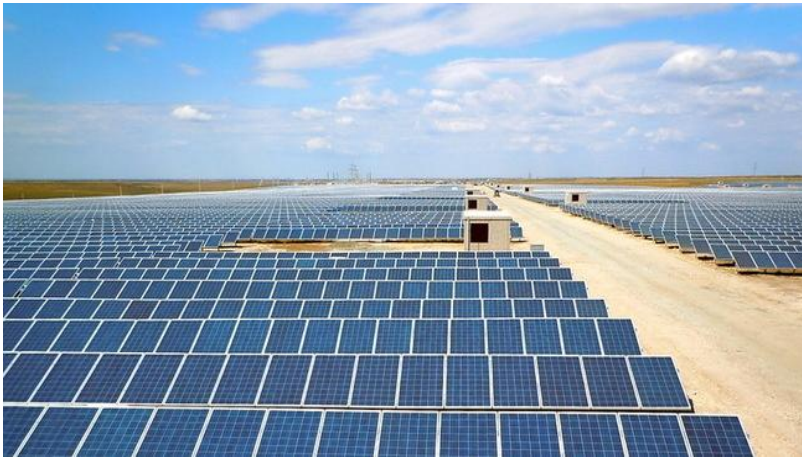
Рис. 2.10. Кримська сонячна електростанція «Перово»
