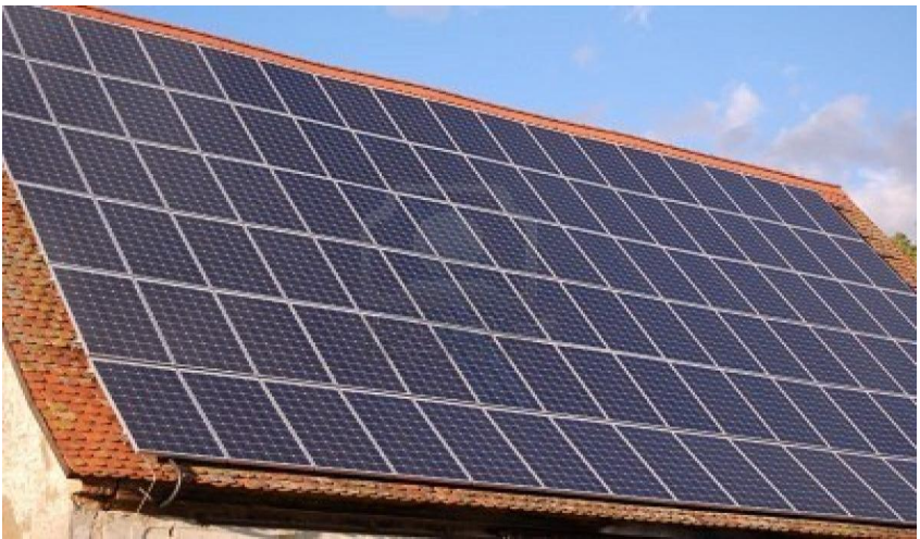
Рис. 2.4. Сонячна батарея на даху будівлі
